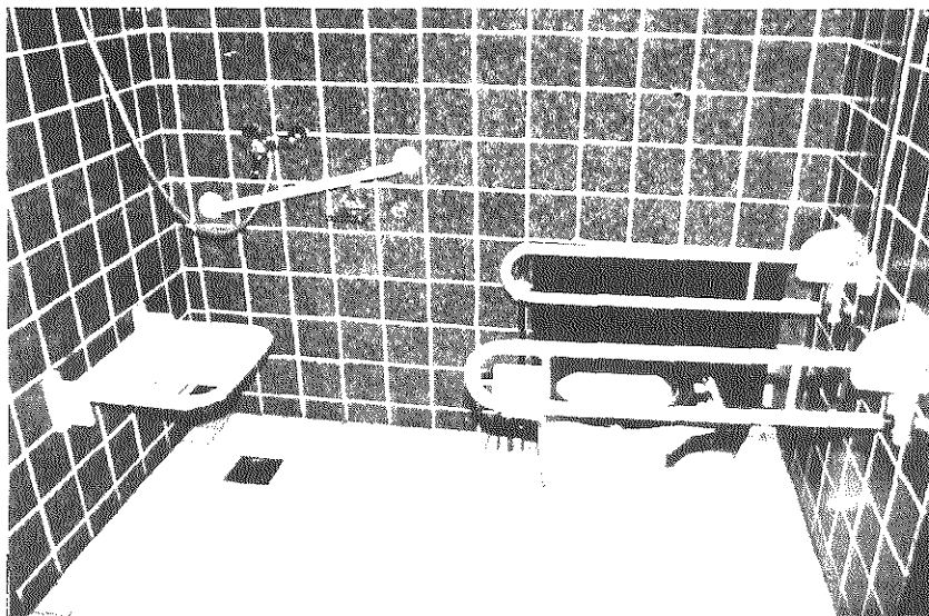
Toegankelijke douche en toilet voor gehandicapten.
